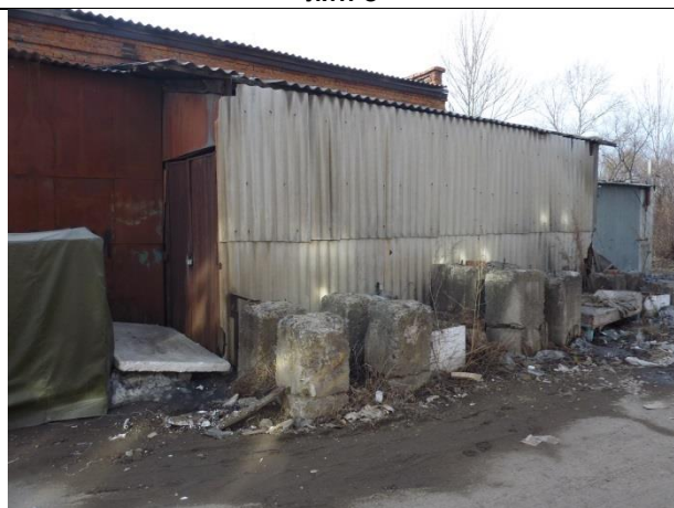
Фото 1.4. Центральная распределительная подстанция, лит. О
