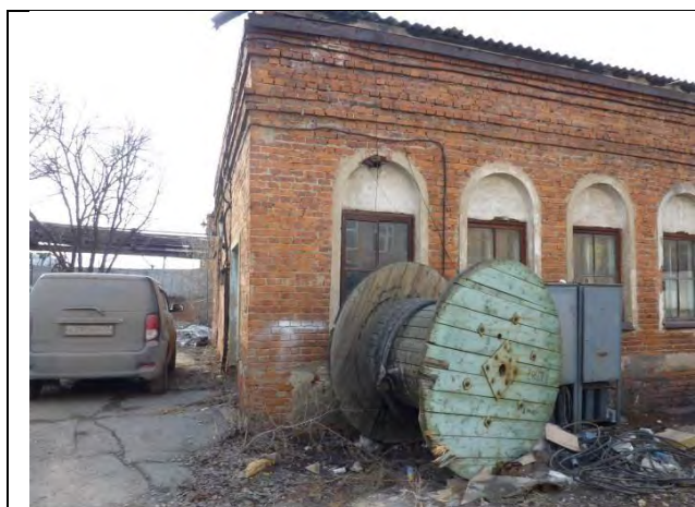
Фото 1.1. Центральная распределительная подстанция, лит. О
